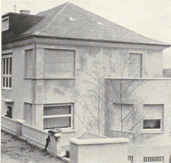
Bild 280. Ausblühungen in Edelputz, die auf schlechtes Ziegelmaterial zurückzuführen sind
