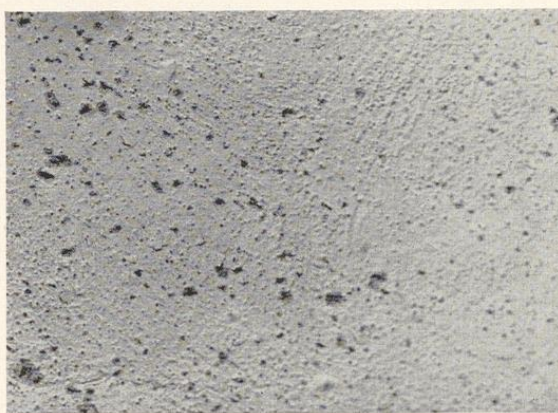
Bild 283. Treiberscheinung im Putz, sogenannte Schrotschüsse, von Kalkgrieben (Kalkmännchen) herrührend
