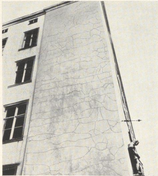
Bild 288. Die ganze Putzfassade ist infolge mangelhafter Putzausführung von feinen Haarrissen überzogen
