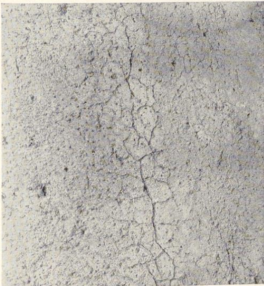
Bild 286. Schlechte Putzausführung. Zu geringer Bindemittelzusatz führt zu starken Rißbildungen im Putz
