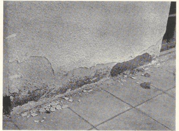
Bild 290. Durch Feuchtigkeit bzw. Frost zerstörter Edelputz, hier fehlte ein Sockel aus Zement- oder Steinputz
