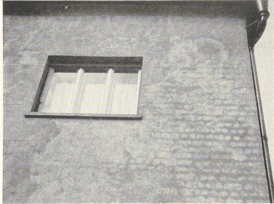
Bild 289. Durchschlagen der Fugen infolge zu schwachen Putzes
