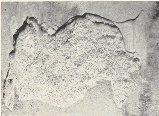
Bild 293. Guter Oberputz auf einem schlechten Unterputz löst sich bei Einwirkung von Feuchtigkeit ab
