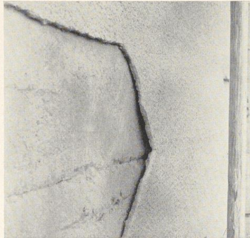
Bild 295. Pressungen und ungenügende Haftfestigkeit führen zur Abreibung des ganzen Putzes
